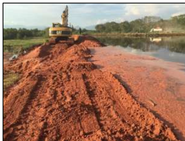
Figura 81 – Vista do trecho rompido, foco em montante (22/03/2016).
