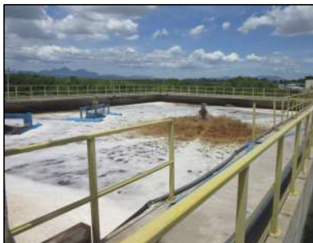
Figura 127 – Tanque de aerção (21/02/2018).
