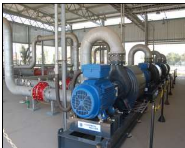
Figura 43 – Maquinário usado para o Biogás, datada de 2009.
