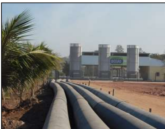
Figura 42 – Tubulação principal, também conhecida como Header, datada de 2009.
