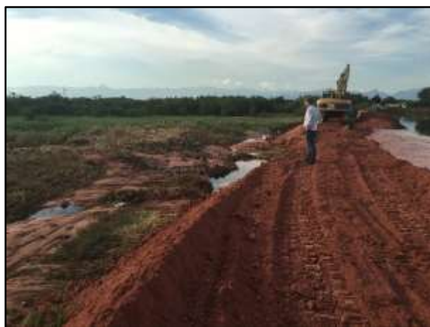
Figura 80 – Vista do trecho rompido, foco em jusante (22/03/2016).
