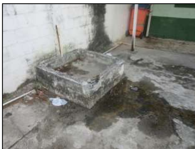
Figura 106 – Detalhe de algumas manchas no pavimento (21/03/2018).
