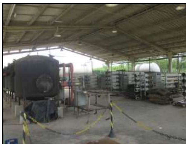
Figura 129 – Tanques de carvão unidade de nanofiltração (21/02/2018).
