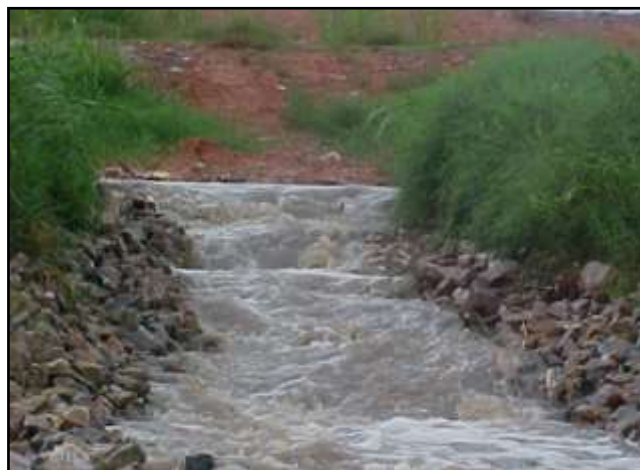
Figura 29 – Sistema de drenagem de águas pluviais.
