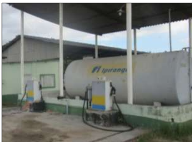
Figura 103 – Tanque de combustível (21/03/2018).
