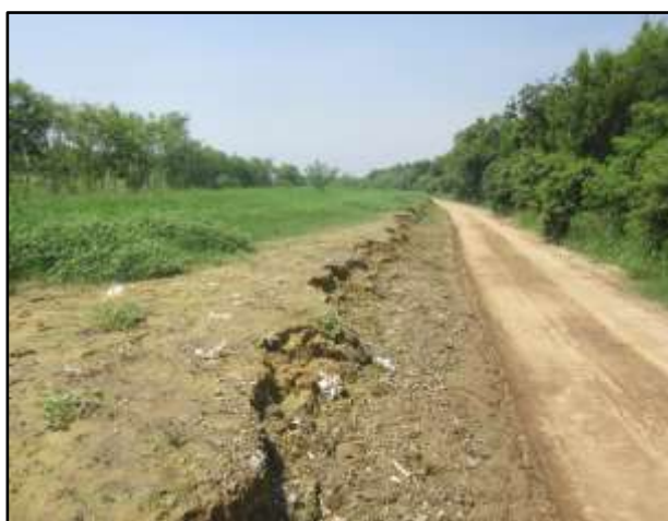
Figura 140 – Detalhe do dique da Vala Sul 2 apresentando feições erosivas (14/03/2018).
